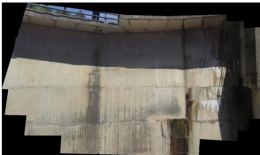
Figura 4 – Ortomosaico obtido com imagens capturadas pela aeronave em ambiente operacional na barragem de Fagilde
